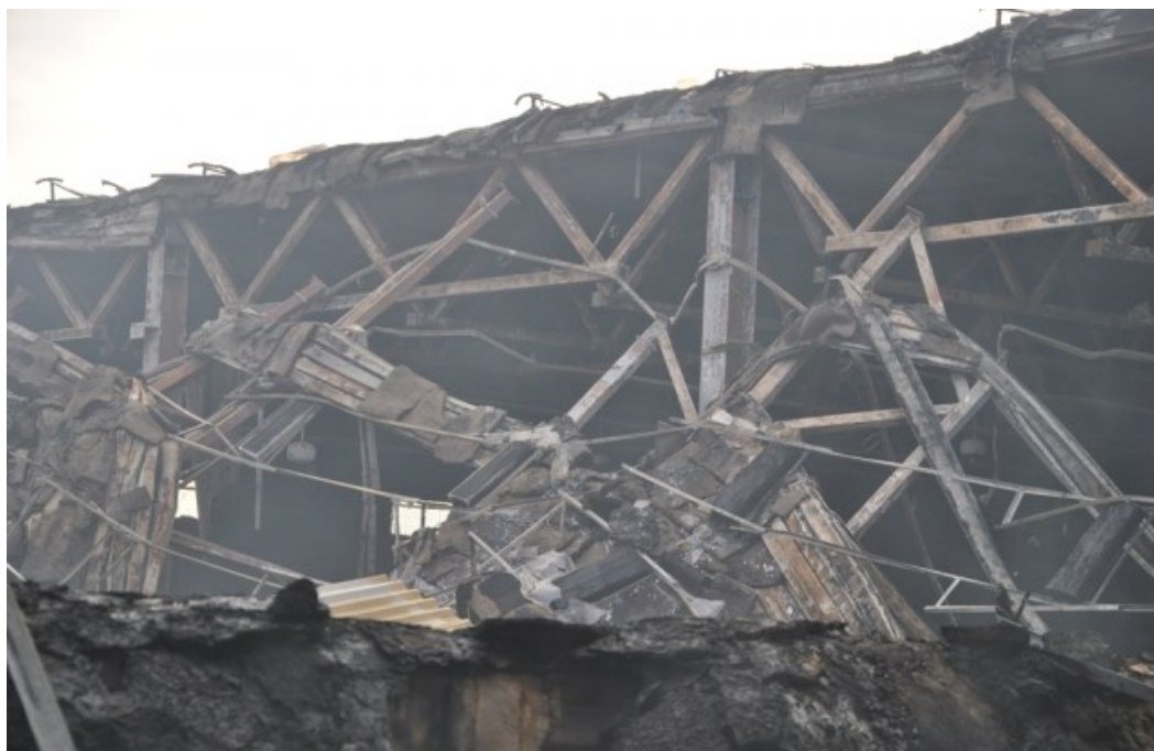
Рисунок 1.2 – Руйнування фермової конструкції внаслідок пожежі
