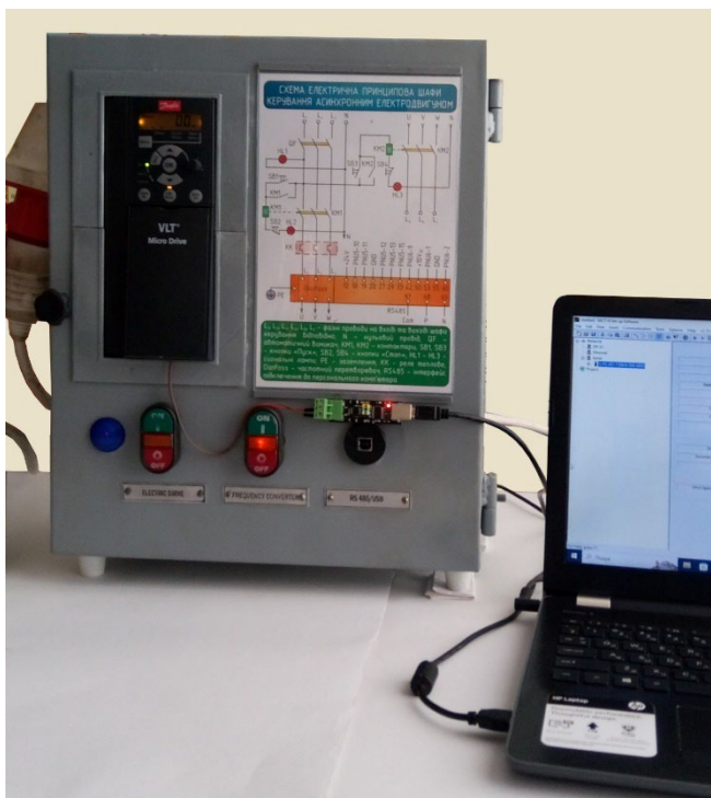
Частотний перетворювач і обладнання для реєстрації температури
